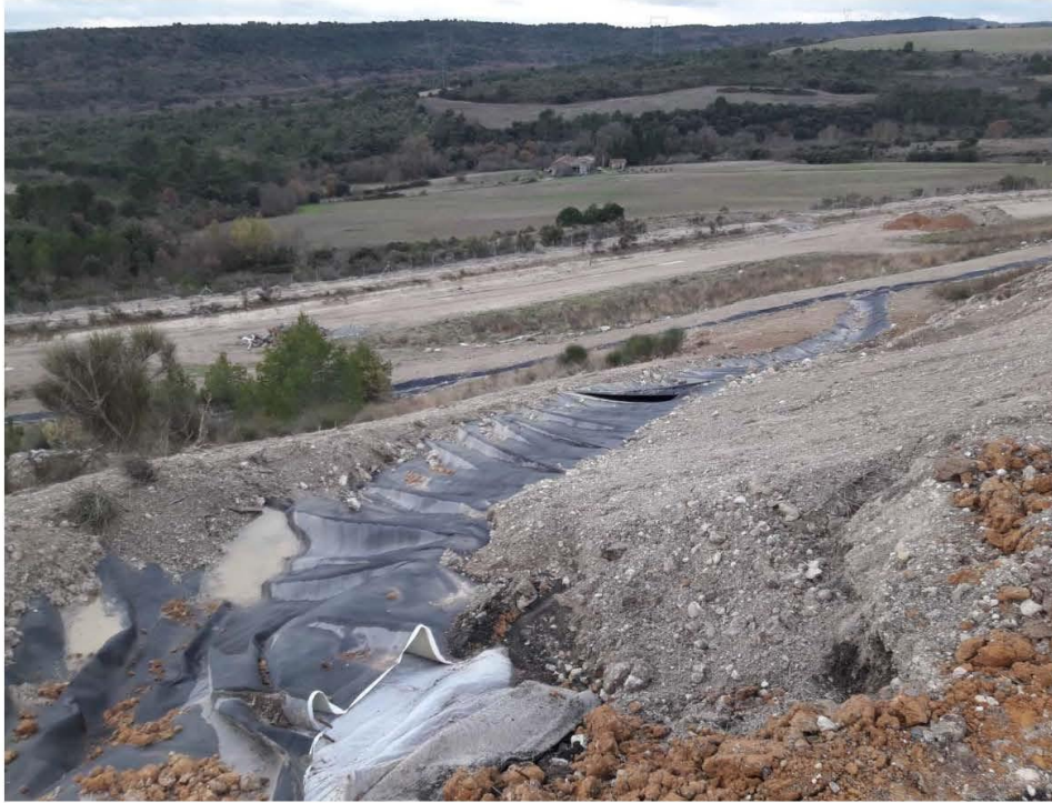
Zone 7.1 : Fossé Sud Est avec désordres à reprendre
