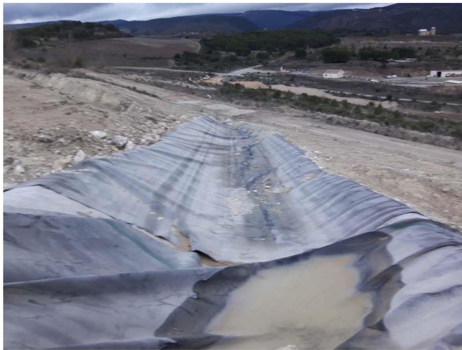
Point d'observation 11 : zone de suintement sans signe d'instabilité observée depuis 2011 terrassée avec pose d'une géomembrane
