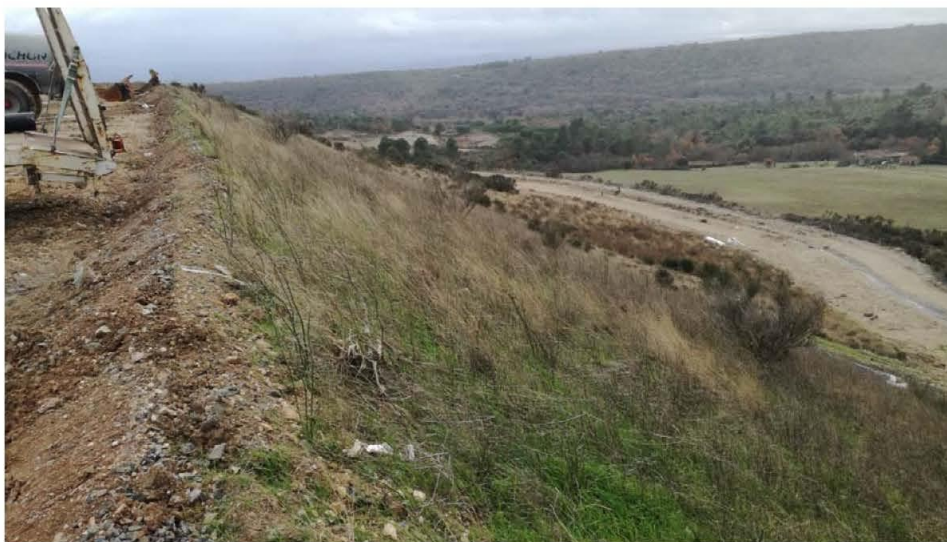
Points d'observation 5 et 6 : Ancienne zone instable sans évolution notable depuis son traitement en 2007
